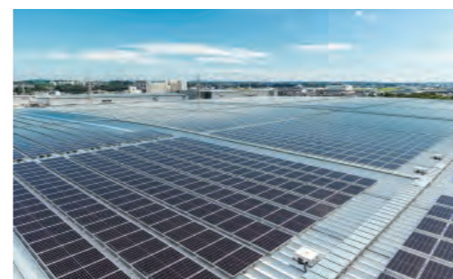
屋上に設置された太陽光パネル
