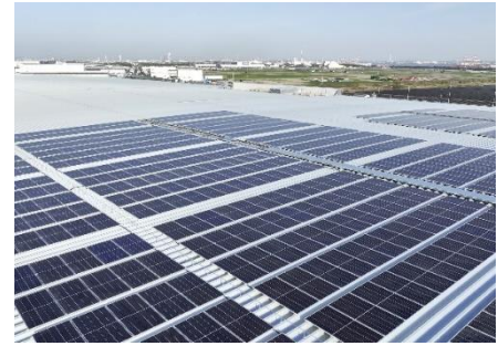
<太陽光パネル>
