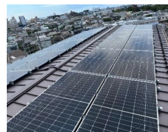
【設置した太陽光パネルの一部】
