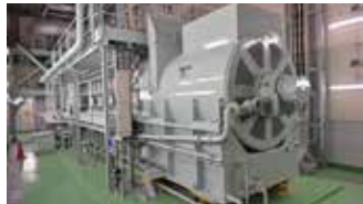
东京中城八重洲内能源中心
