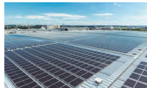
屋上に設置された太陽光パネル
