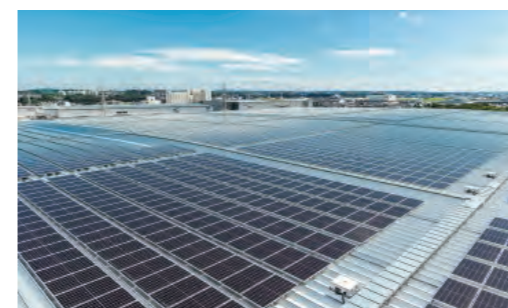
屋上に設置された太陽光パネル
