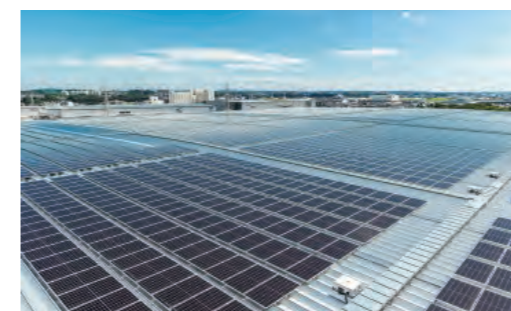
屋上に設置された太陽光パネル
