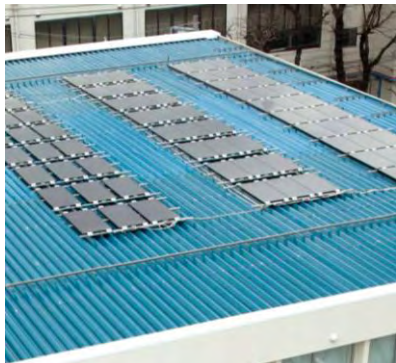
太陽光パネル
