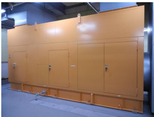
非常用発電機
