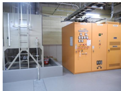
燃料タンク（一部）
