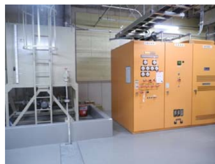
燃料タンク（一部）
