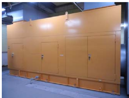
非常用発電機
