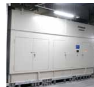
日本橋三井タワーの非常用発電機
