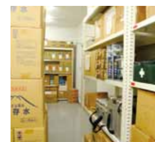
日本橋三井タワーの災害備蓄倉庫
