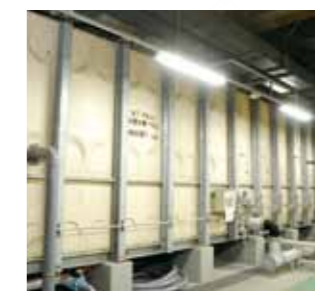
日本橋三井タワーの上水貯水槽
