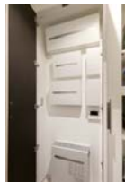
蓄電池・分電盤
