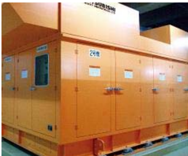
コージェネレーションシステム
