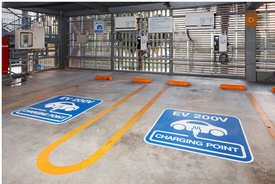
電気自動車（EV）用壁掛型普通充電器
