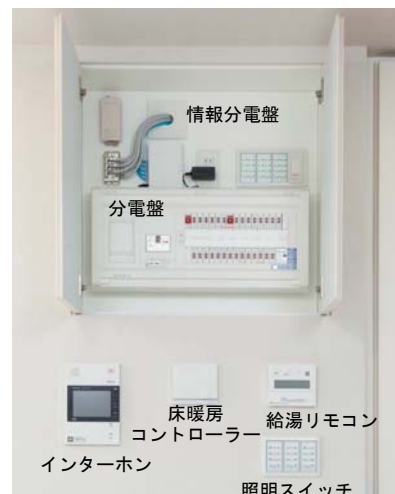
集約した設備スイッチ
