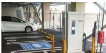
電気自動車充電ステーション 平面駐車場に2台分を用意。
