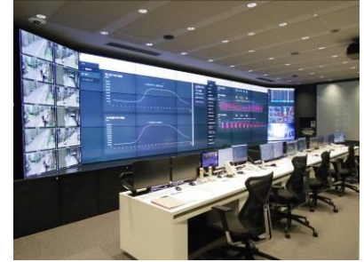
日本橋エネルギーセンター
