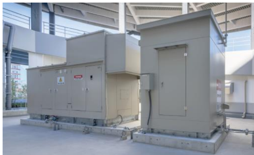
非常用発電機
