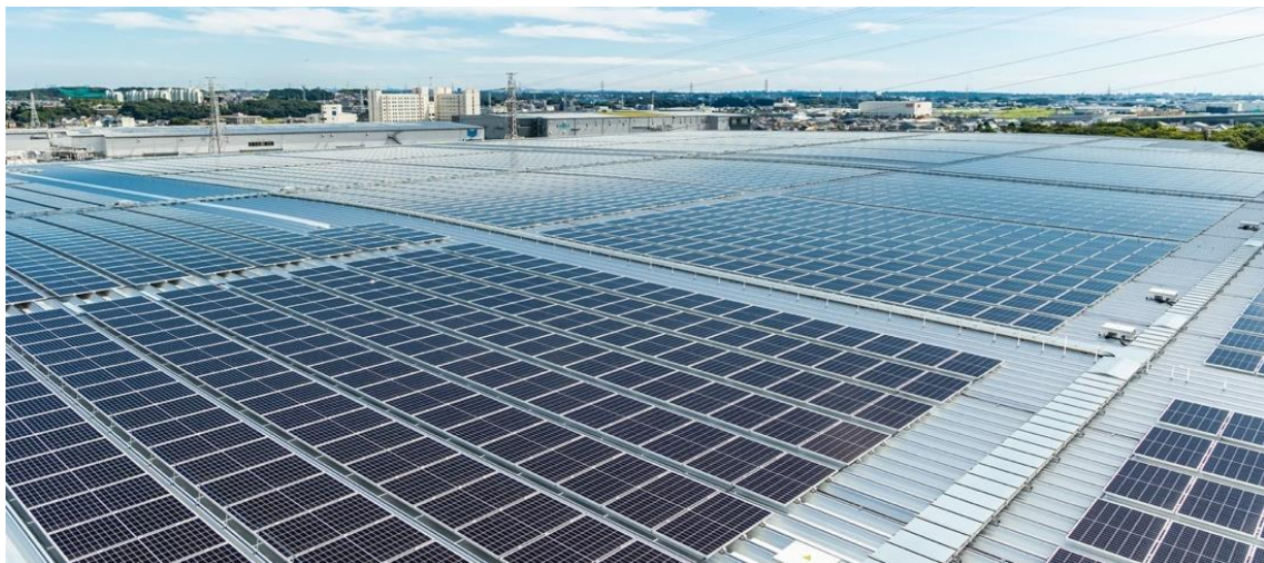
屋上に設置された太陽光パネル
