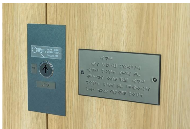
非接触型のエレベーターボタン
