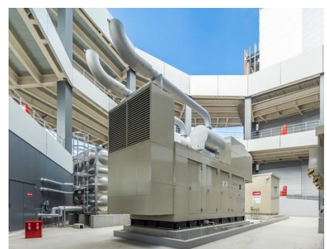
非常用発電機
