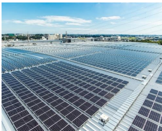
屋上太陽光発電設備イメージ
