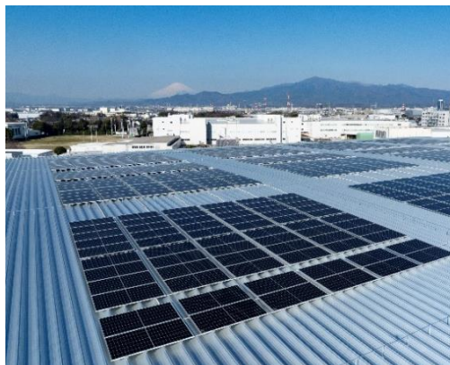
太陽光発電設備
