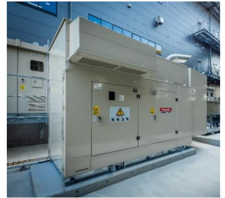
非常用発電設備
