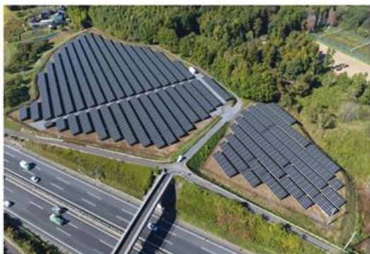
谷向太陽光発電所
