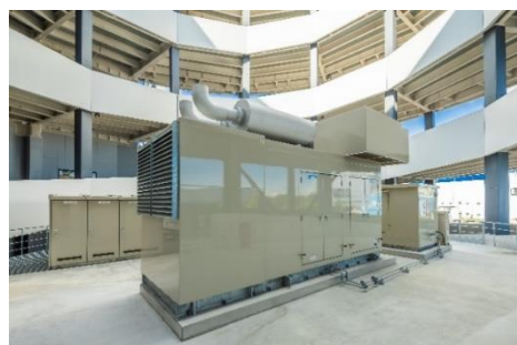
72 時間対応非常用発電機
