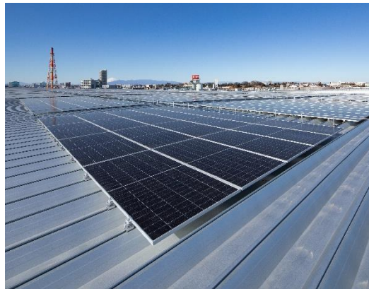
太陽光発電設備
