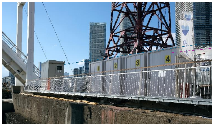
豊洲船着場隣接の給電設備
