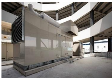
非常用発電機
