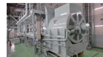
東京ミッドタウン八重洲内エネルギーセンター
