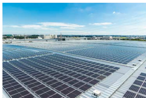
「MFLP海老名Ⅰ」屋上に設置された太陽光パネル
