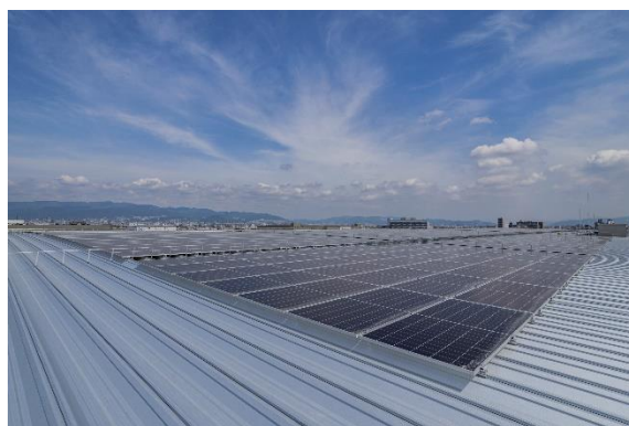
太陽光発電設備
